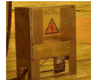
COFFRET DE CHANTIER
