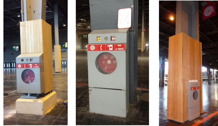
RIA - ROBINET D'INCENDIE ARMÉ
