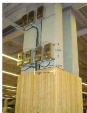
Figure 7 – Coffret de secteur (à laisser accessible) Attention, nombre de coffrets différent selon les poteaux
