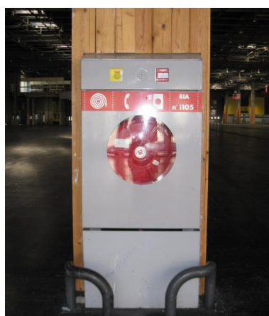
Figure 8 – Robinet d'Incendie Armé (RIA)
