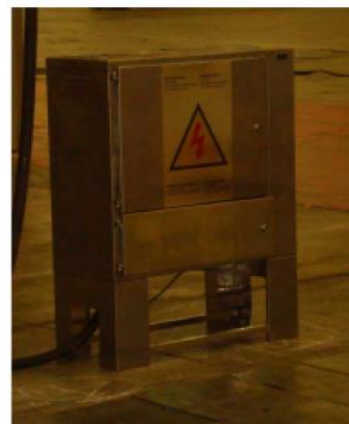
Figure 5 – Armoire électrique (puissance supérieure à 20kW)
